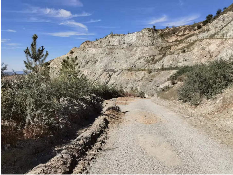
运输道路一侧土质排水沟
